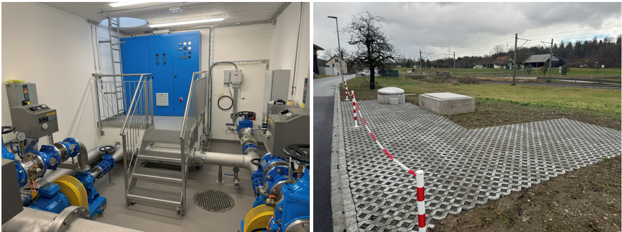
Stufenpumpwerk Hardstrasse Innen- und Aussenansicht, Wildegg/Rupperswil
