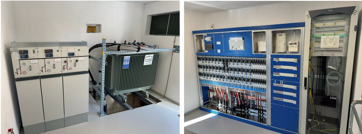
Mittel-/ Niederspannungs- und LWL-Verteilung inkl. Trafo TS Engelmatt, Niederlenz
